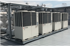
浦和工場 冷凍機
