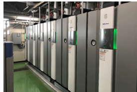
浦和工場 貫流ボイラー
