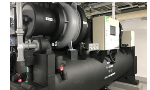
浦和工場 冷水チラー用冷凍機
